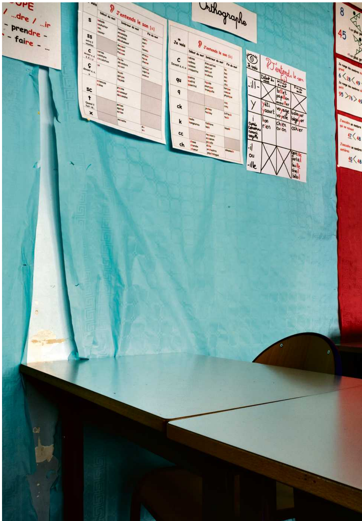
Une salle de classe marseillaise, vendredi, dont les murs délabrés sont cachés derrière des nappes en papier.
